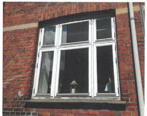
Vinduerne mod gården er værst ramt umiddelbart.
