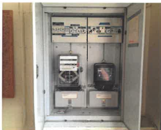
Man kunne med fordel få fornyet og moderniseret ejendommens hovedtavler.
