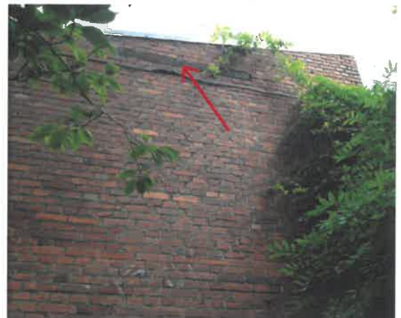
Gavlens her er oplagt at få efterisoleret, bemærk jernbjælken øverst.
