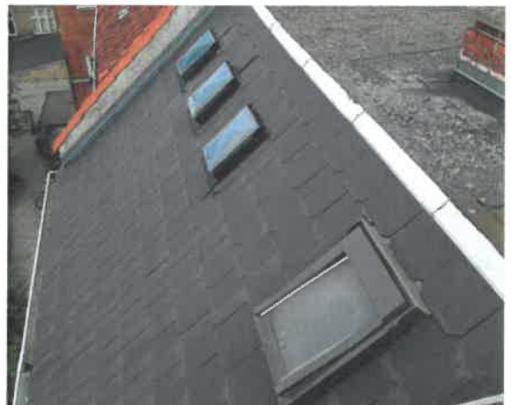
Det er denne tagside ind mod gården, som skal bygges helt om.
