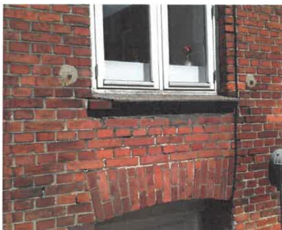
| Skadet murværk i gård, ødelagt sålbænk mv.
