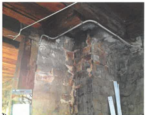
Skorstenskernen set indefra, med massive fugtskader.
